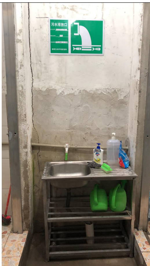
污水排放口远景
